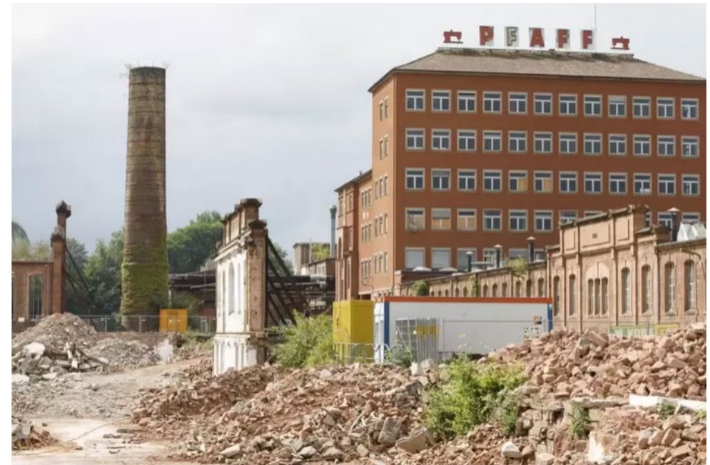
Seit dem Jahr 2017 rollen auf dem 19 Hektar großen Gelände an der Königstraße die Bagger.
